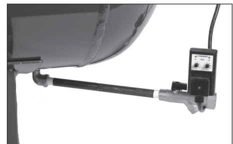
Figura 11 - Drenaje automático del tanque
